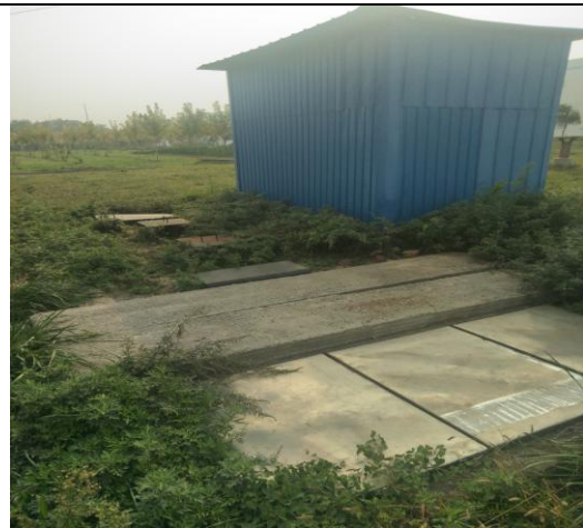
二级生化处理装置
